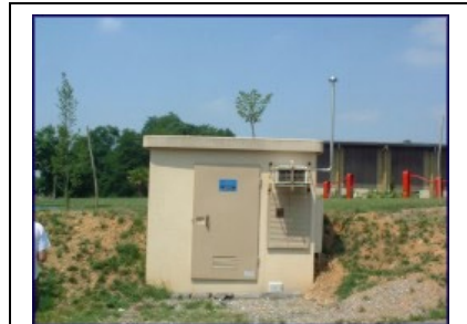
Photo 3 : Station de proximité industrielle
